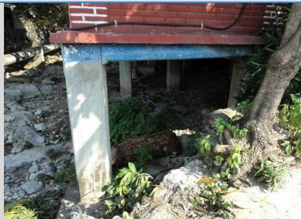
LOCALIDAD LOS ARCOS Vivienda con pilares sobre el cauce.
