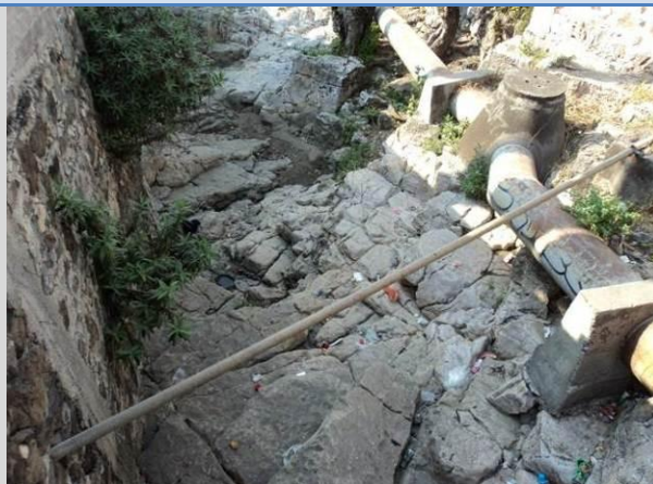
LOCALIDAD LOS ARCOS Material sobre el cauce.
