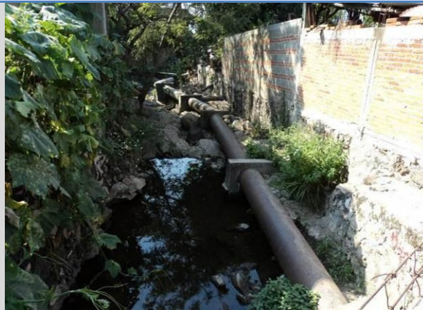
LOCALIDAD LOS ARCOS Tubería sobre el cauce de la barranca
