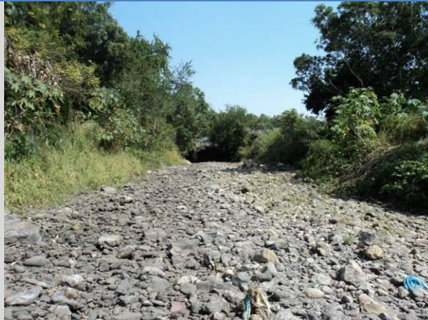
LOCALIDAD OACALCO Arrastre de material en río de Oacalco..
