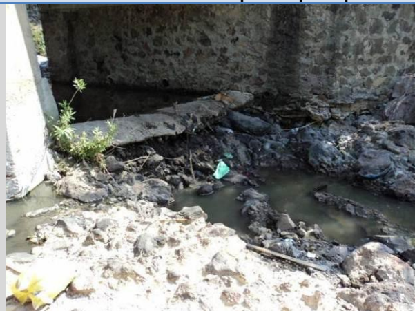
LOCALIDAD OACALCO Abajo del puente existe presencia de basura y arrastre de material.
