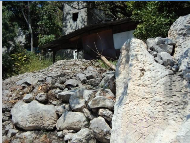
LOCALIDAD LA JOYA Viviendas en zona de caída de bloques.
