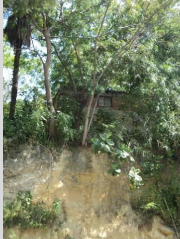
LOCALIDAD LA JOYA Existen las posibilidades de deslizamientos en la zona.
