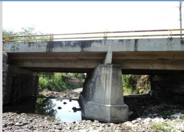
LOCALIDAD OACALCO Presencia de material en puente Oacalco.
