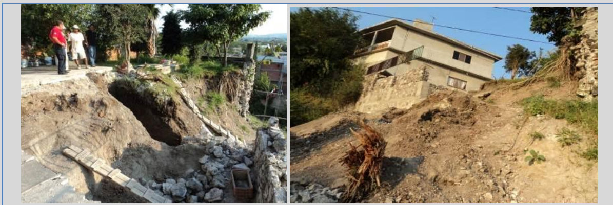
Imagen 25 y 26. Afectaciones por la inestabilidad de laderas. Fuente: elaboración propia
