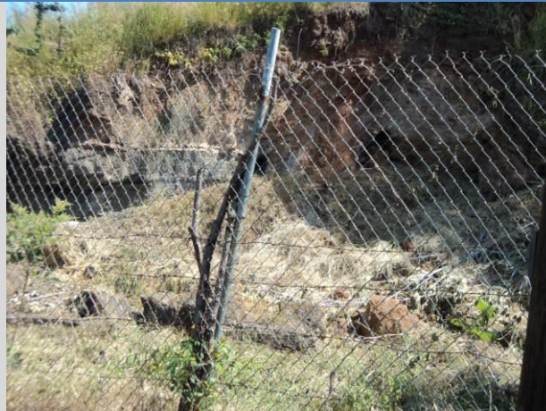
LOCALIDAD LA JOYA Viviendas con escurrimientos a falta de drenaje.
