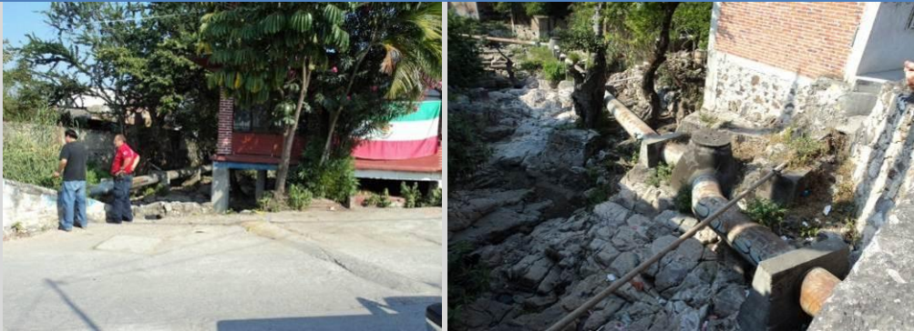
Imagen 41 y 42. Imagen de la tubería expuesta por el cause de los ríos en el Centro de Los Arcos.
